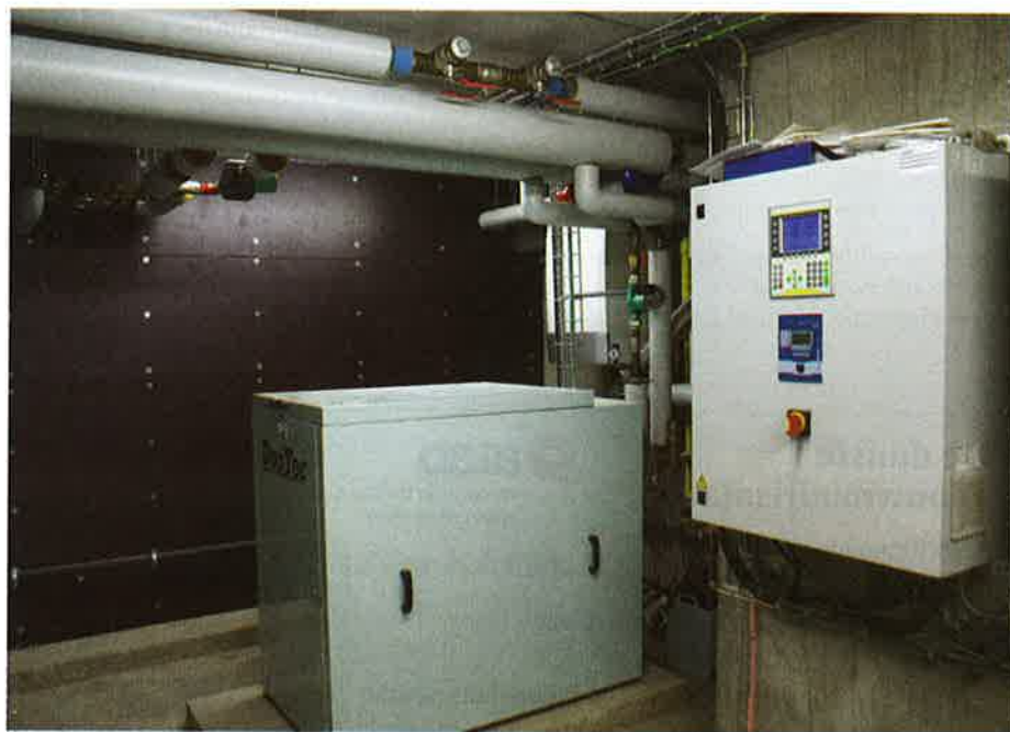
De afgewerkte wkk-installatie in de kelder van het hotel, waarbij de paraffinekokers achter de zwarte wand verscholen zitten.
